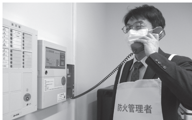
火災通報装置を使用する防火管理者 (眼科クリニックMiRAI事務室の丹羽克也部長)
