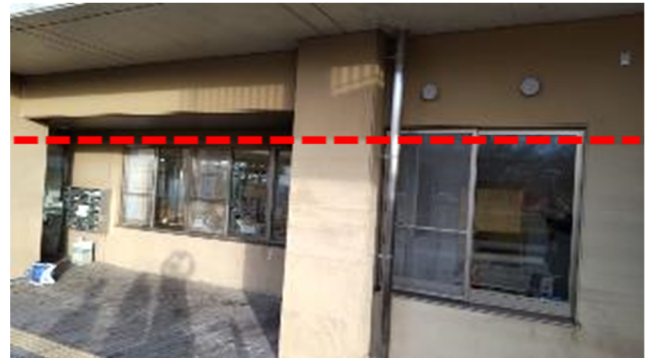
(台風 19 号の浸水跡) (建物 2 階まで浸水：赤線)
